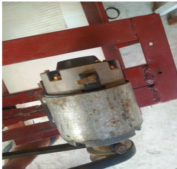
Penempatan Generator Untuk PLTMH
