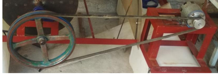
Gambar 4.2 Penempatan Generator Untuk PLTMH
