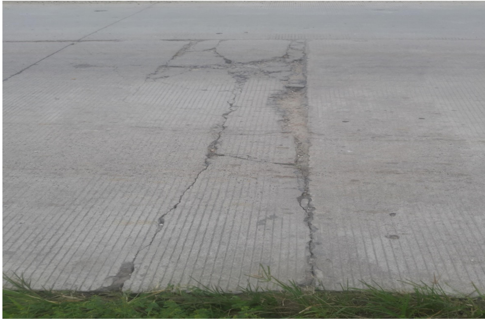
Kerusakan Retak Lurus ( Linear Crack )
