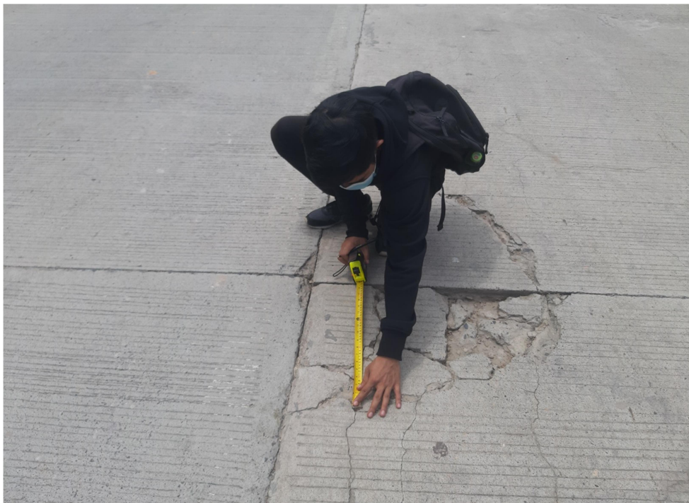
Kerusakan Pecah Sudut ( Corner Crack )
