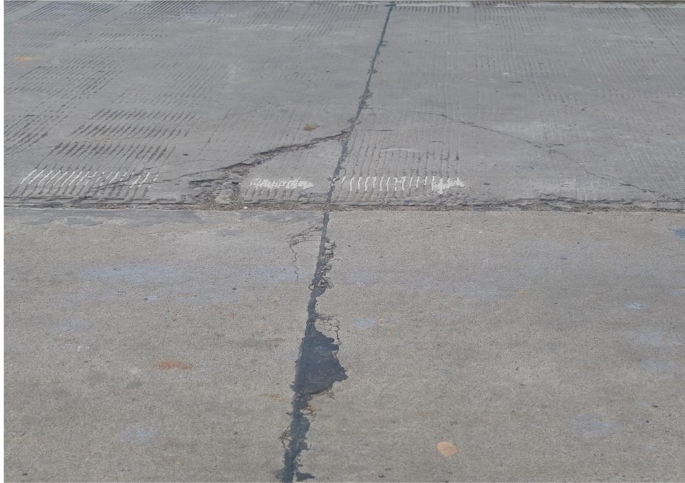
Kerusakan Pecah Sudut ( Corner Crack )
