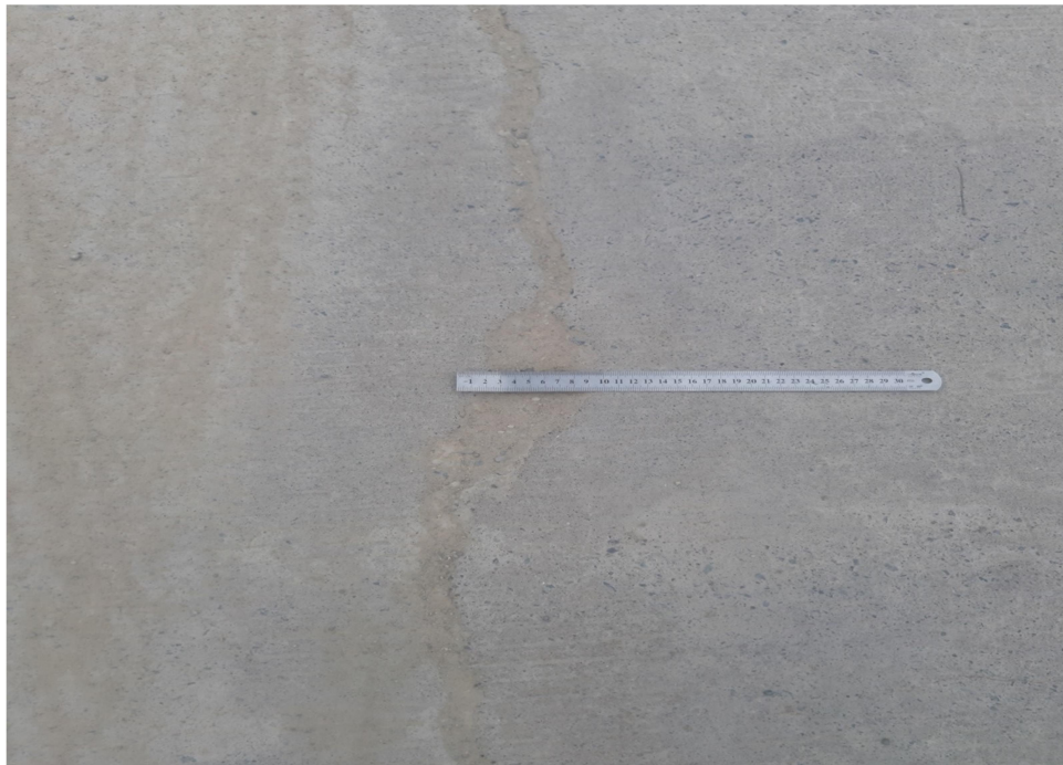
Kerusakan Retak Lurus ( Linear Crack )
