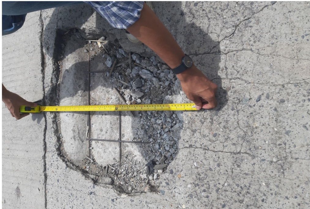
Kerusakan Lubang ( Patholes )
