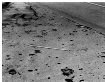
Gambar 2.13 Kerusakan Pelepasan ( Popouts ) pada perkerasan jalan
