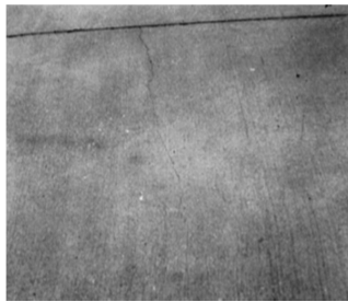
Gambar 2.18 Tingkat Kerusakan Retak Susut Pada Perkerasan Jalan
