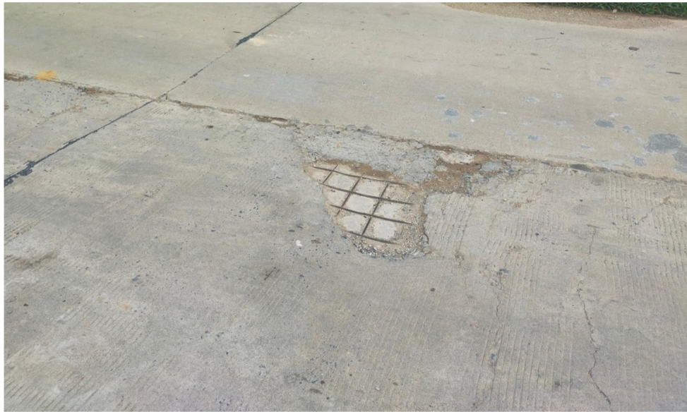
Jenis Kerusakan Pecah Sudut ( Corner Crack )
