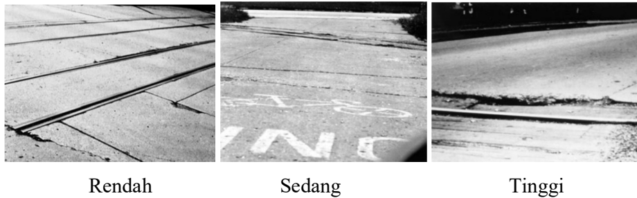
Gambar 2.15 Tingkat Kerusakan Perlintasan Karet Pada Perkerasan Jalan Sumber : ASTM Standard Practice For Roads and Parking Lost Pavement Condition Surveys 2007
