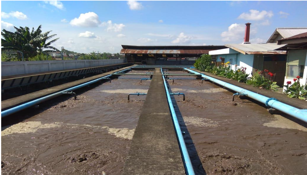
Gambar 4.11 Bak Denitrifikasi (Clarifier) (Dokumentasi Lapangan,2021)
