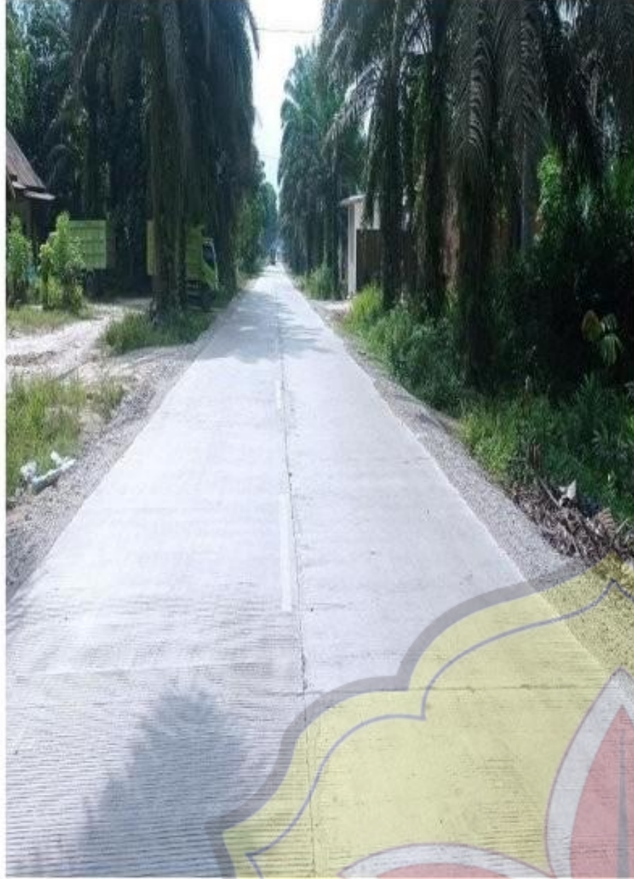
Kondisi existing jalan tempino-muara bulian
