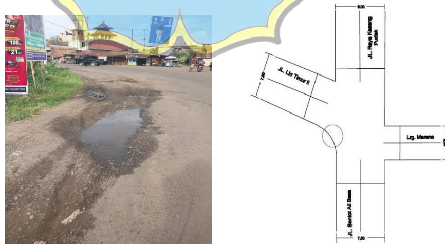
Gambar 4.11 kondisi bahu jalan yang rusak
