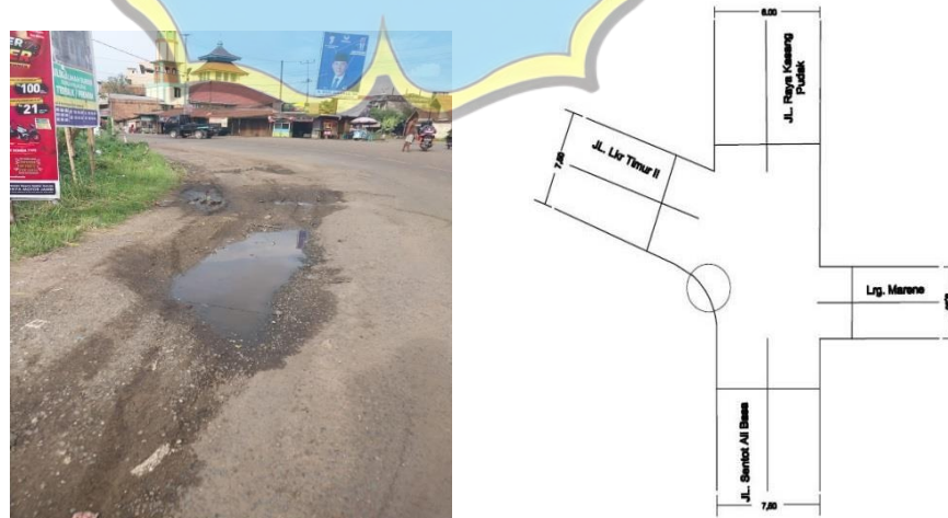
Gambar 4.11 kondisi bahu jalan yang rusak
