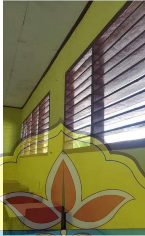
Gambar 4.7 Jendela Ruangan Kelas yang Tidak Tepat
