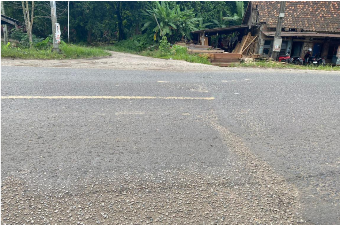
Gambar 15 Foto Kerusakan Jalan dan Penurunan Kualitas Jalan Sumber : Data Olahan, 2023
