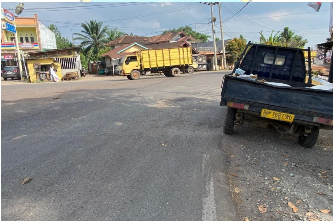
Gambar 16 Foto Kerusakan Jalan dan Penurunan Kualitas Jalan Sumber : Data Olahan, 2023
