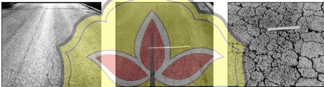
Gambar 2. 4 Lebar Retakan Permukaan Perkerasan.
