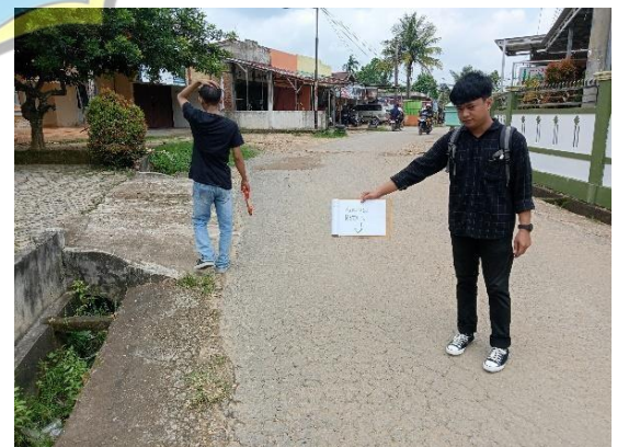
Gambar 4 Kerusakan Retak Setempat
