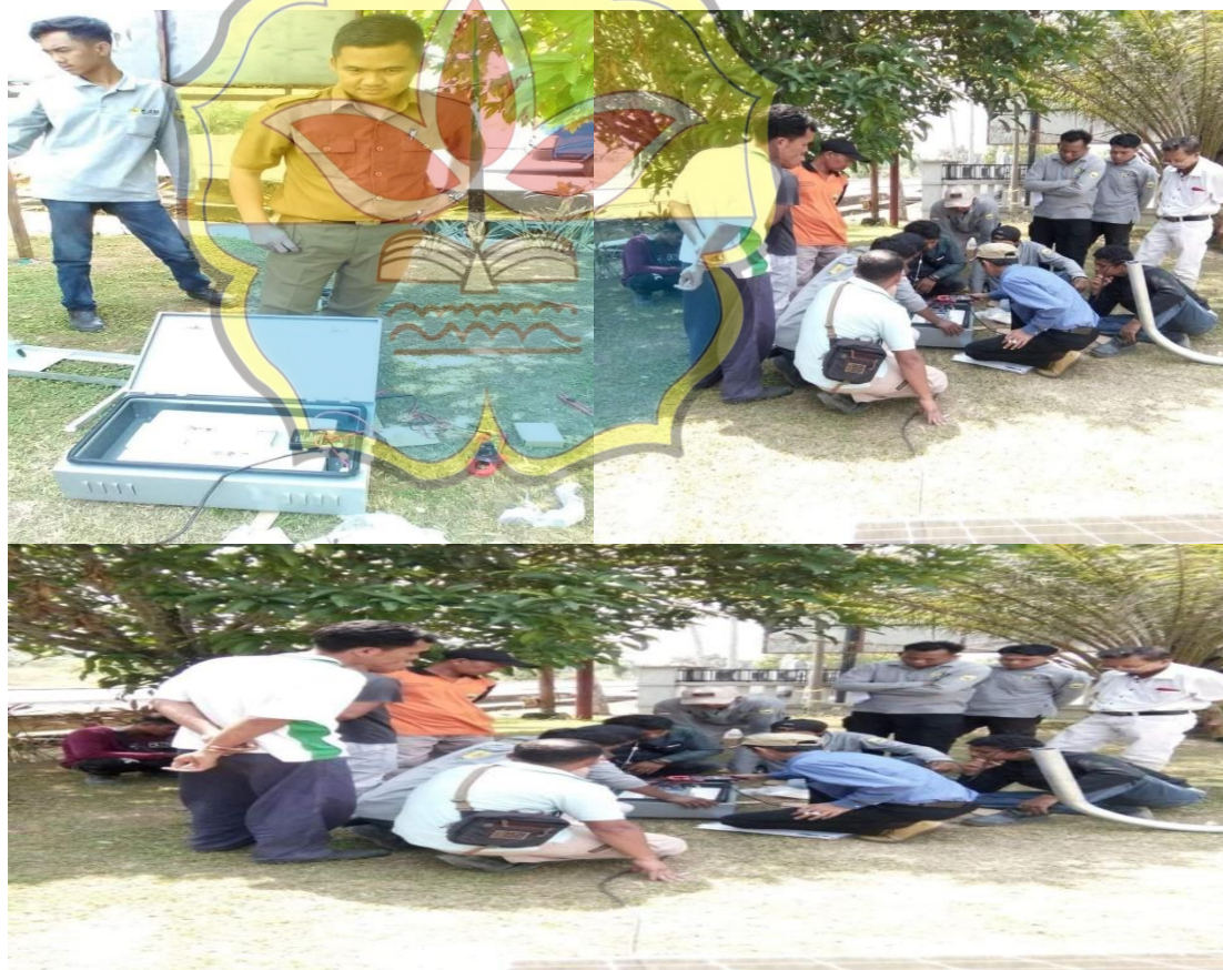
Gambar I Dokumentasi Pihak Dinas Perumahan Dan Pemukiman (Perkim) Kabupaten Muaro Jambi Memeriksa Lampu Penerangan Jalan Tenaga Surya Yang Telah Di Curi
