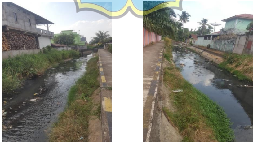
Gambar 3.1 Kondisi Drainase yang ada di Kelurahan Budiman
