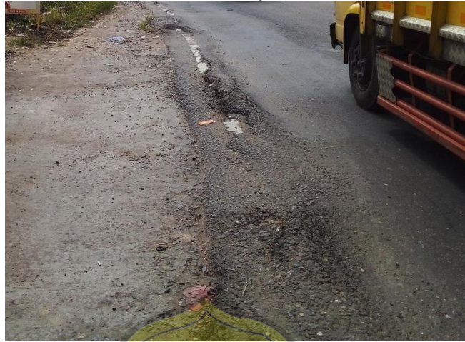
Gambar 1.1 Survey Jalan Rusak
