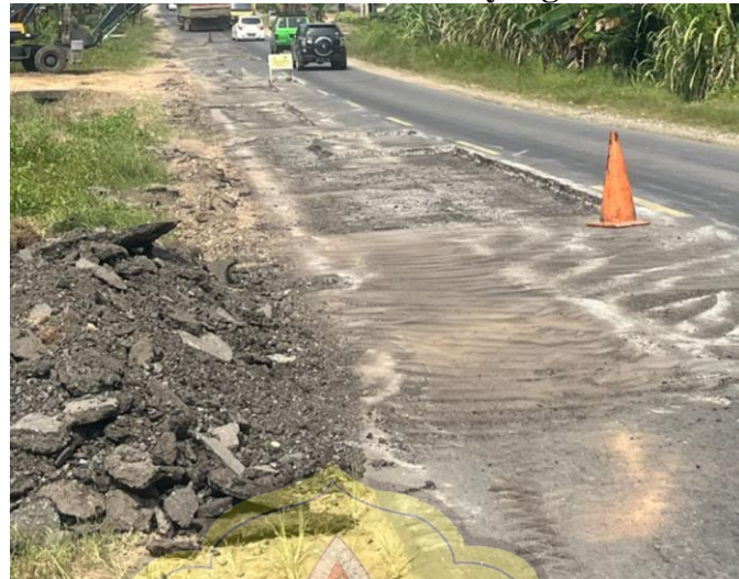
Gambar 1.3 Galian Jalan yang Rusak
